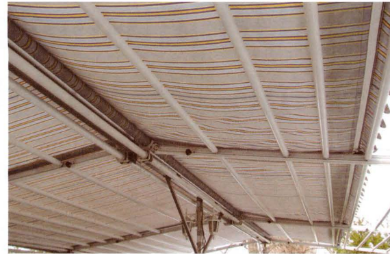
Schon nach kurzer Zeit zeigten sich die Mängel der Neubespannung in Verbindung mit der alten Anlage: Der Kunde beschwerte sich über Faltenbildung sowie mangelnden Wasserablauf; die Grundlage für einen Rechtsstreit.
